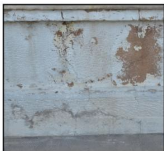
Εικ.9. Ρωγματώσεις του επιχρίσματος.
