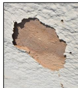
Εικ.11. Επιφανειακή αποσάθρωση επιχρίσματος.
