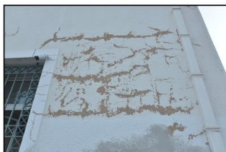
Εικ.13. Ρωγματώσεις του επιχρίσματος και απώλειες βαφών.
